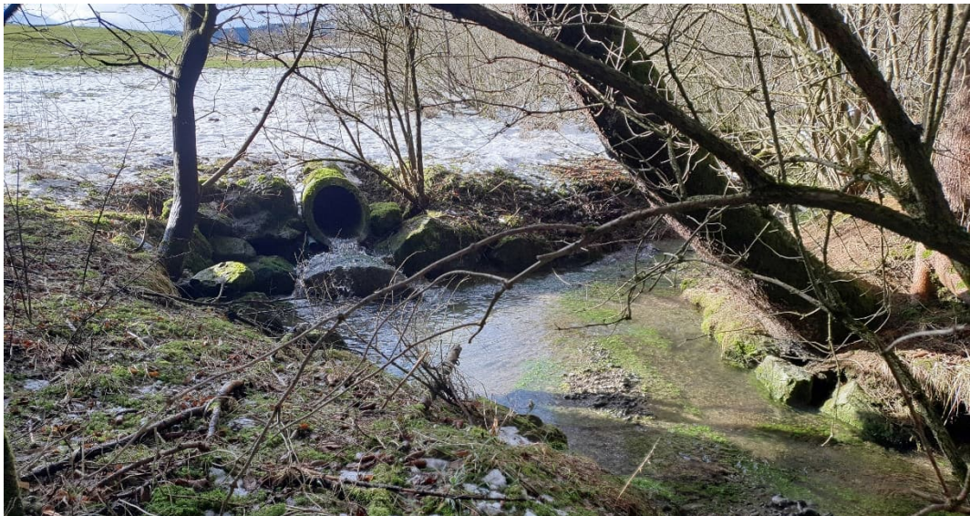
Abbildung 3-1: Einleitungsstelle in den Reigerbach
