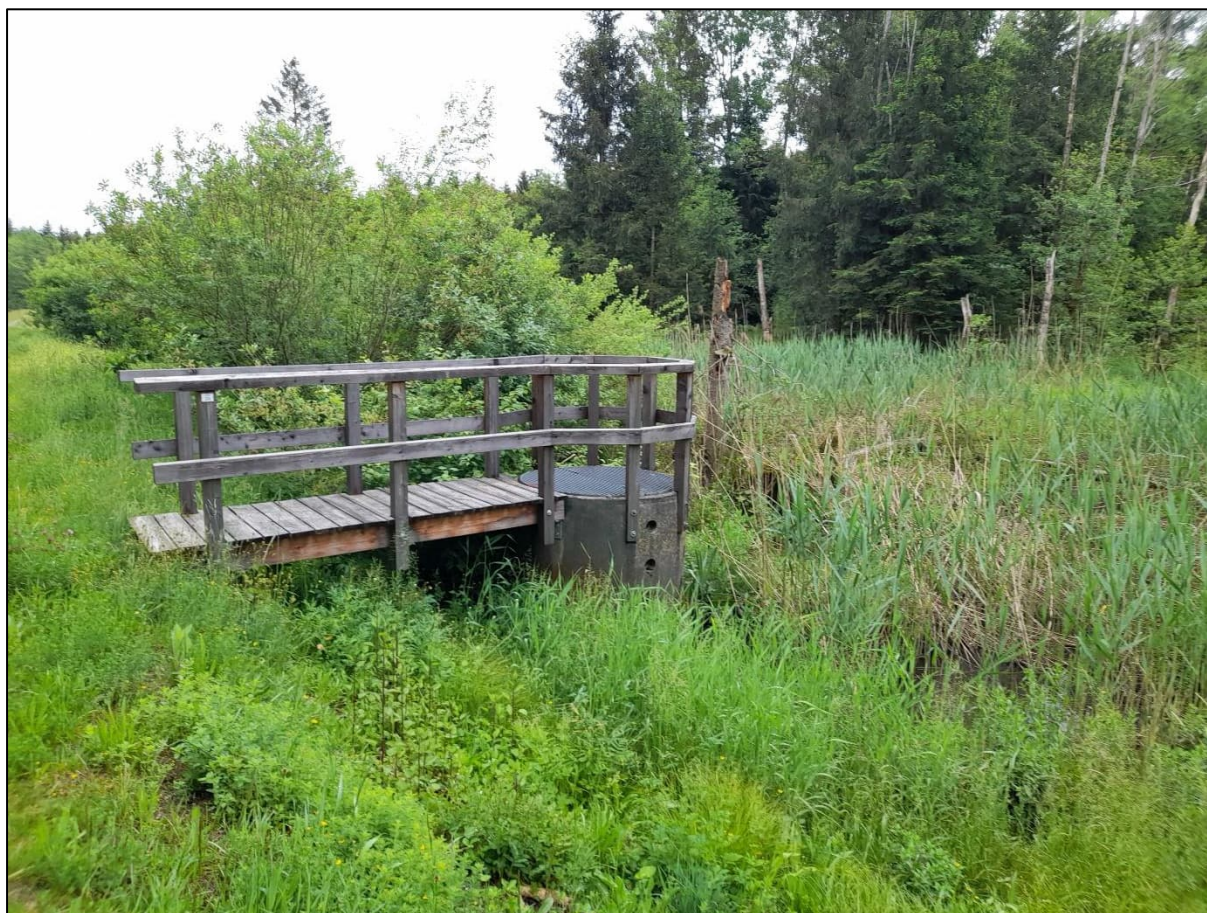
Abbildung 4: Drosselablaufschacht 1 (DS40/1) im Becken I
