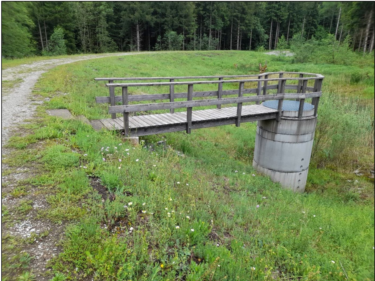
Abbildung 5: Drosselablaufschacht 2 (DS40/3) im Becken III
