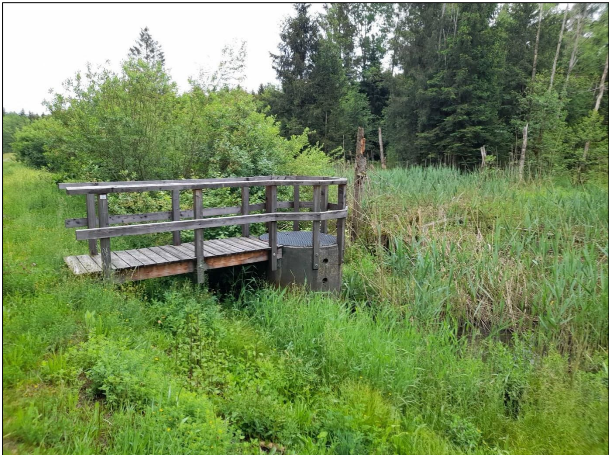
Abbildung 4: Drosselablaufschacht 1 (DS40/1) im Becken I
